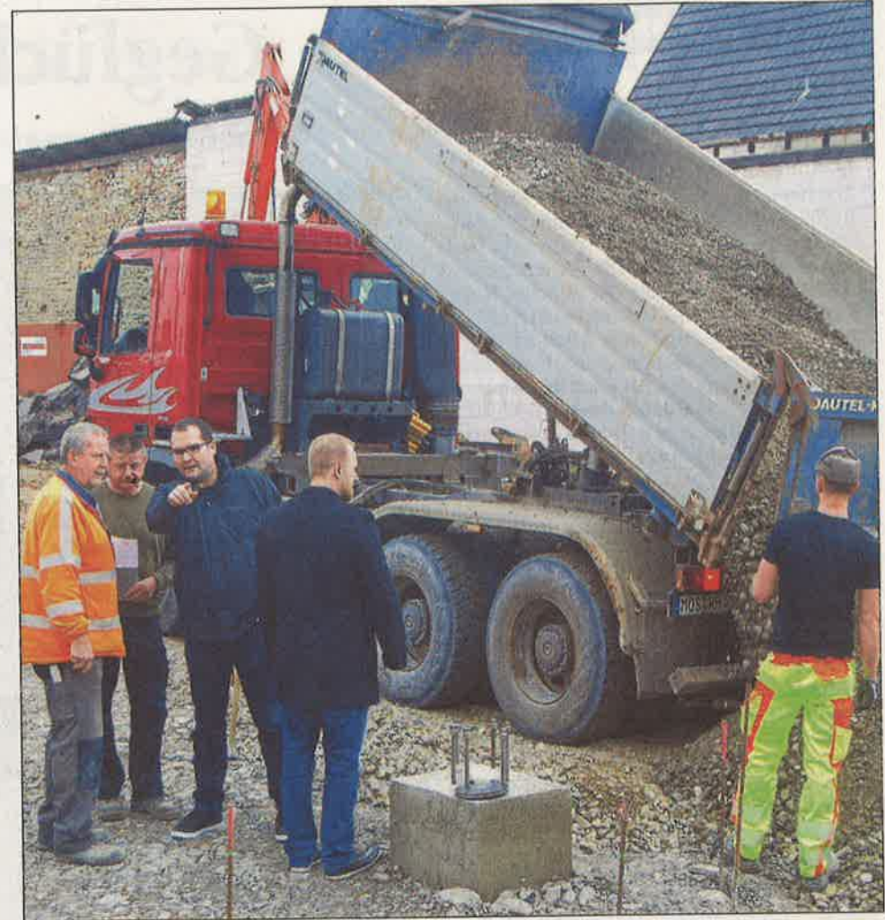
Bürgermeister Siesing, Hauptamtsleiter Ernst und Verantwortliche der Baufirma Helm aus Neckargerach überwachen den Baufortschritt täglich. Da sollte nichts schiefgehen.
