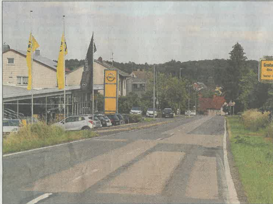
Die Straßendecke in der Ortsdurchfahrt Großeicholzheim soll erneuert werden. Ausführung hierzu nahm der Seckacher Gemeinderat am Montag zur Kenntnis. Foto: Liane Merkle
