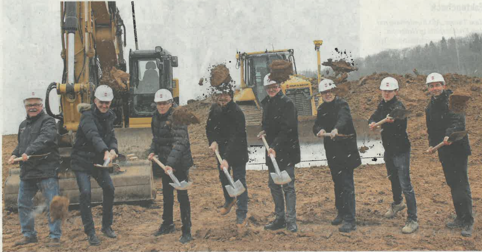
Es kann losgehen: Mit dem symbolischen Spatenstich bei Schneefall erfolgt der Startschuss für die Erschließung des Neubaugebiets „Heilbronner Fußweg“.
