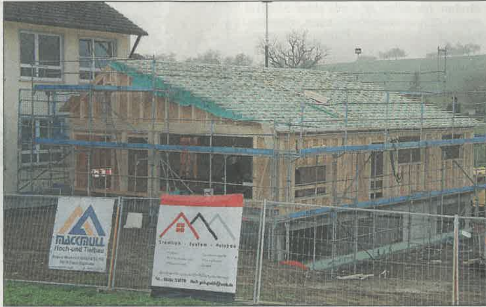
Gut voran gehen die Arbeiten zur Erweiterung der ehemaligen Grundschule in Oberwittstadt, die künftig den Zentralkindergarten der Stadt Ravenstein beherbergt. Foto: Helmut Frodl
